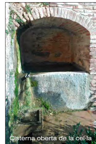
Broc regulació entrada aigua
