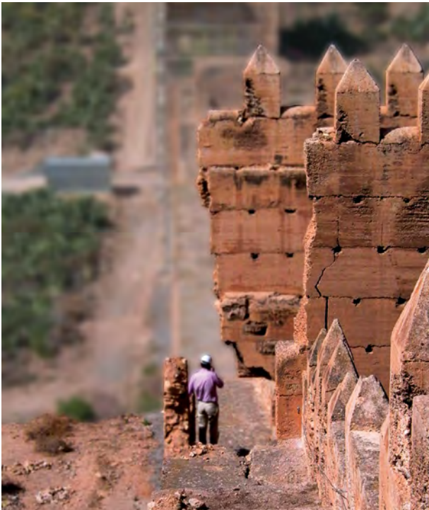
3. Estado inicial de la torre H8.
