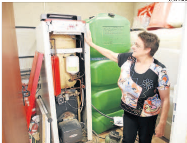
Una afectada mostra desperfectes a la caldera pels talls.
