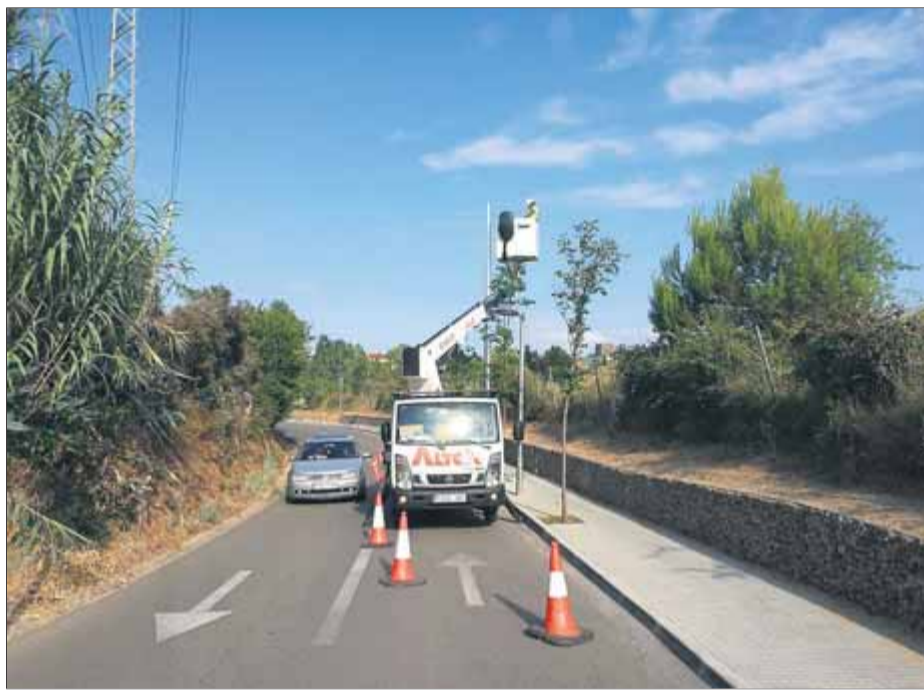
La instal·lació d'enllumenat més eficient és una de les parts del projecte ■ J. TRILLAS
