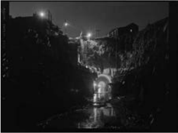
Figura 2. Pando, Juan. Canal de Orellana. Obras de construcción de un túnel del canal de regantes de la presa y embalse de Orellana, en la cuenca hidrográfica del Guadiana. 1963
