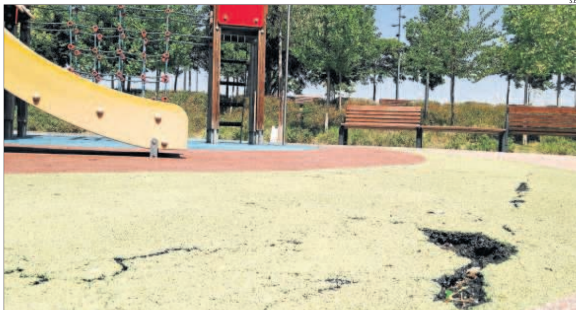
L'estat del paviment de cautxú del parc infantil Màrius Carretero, vora Sant Ruf.
