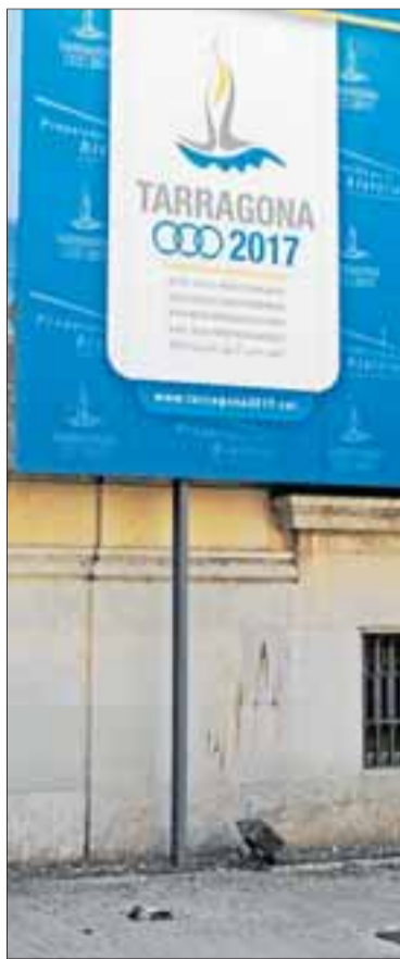
Suciedad y una paloma muerta a un lado de la fachada. FOTO: LL. MILIÁN
