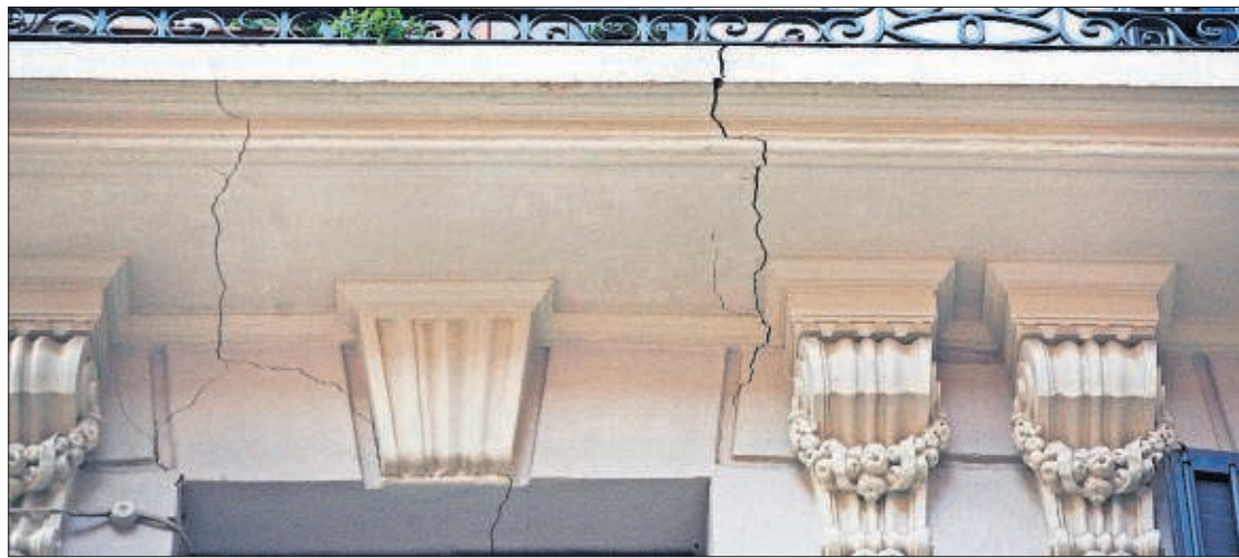
Fachada agrietada de un edificio en Barcelona. / ALBERT GARCIA
