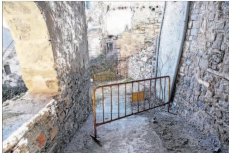
Tanques col·locades per limitar l'accés per perill d'esfondrament.
