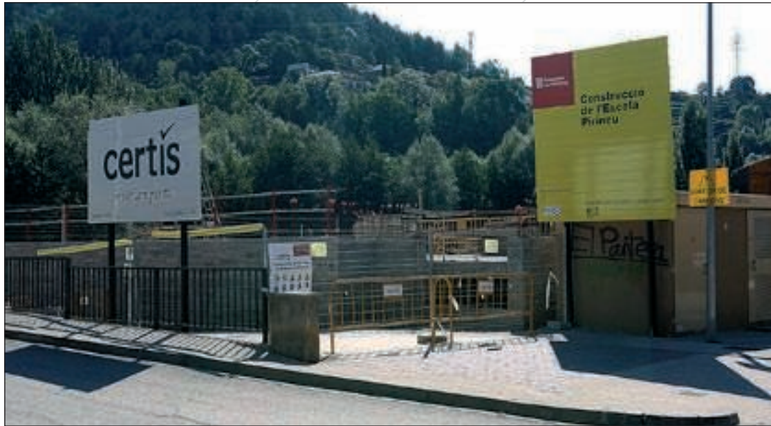
La nova escola es construeix a Can Ribalaigua. Ara fa més de tres mesos que les obres estan aturades
